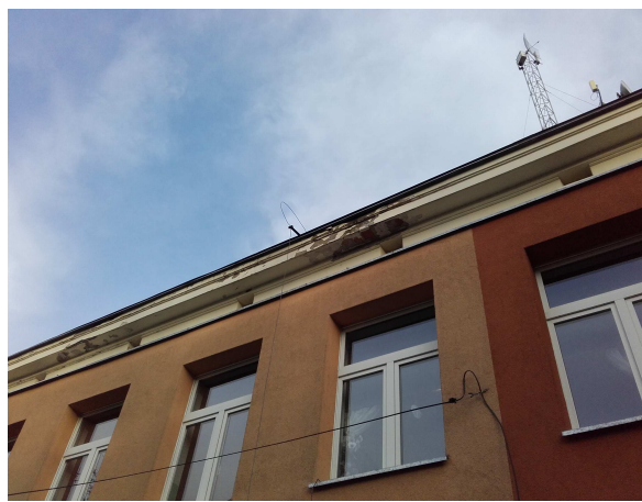
UBYTKI TYNKU NA GZYMSIE
