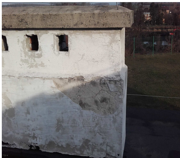
UBYTEK TYNKU NA KOMINIE
