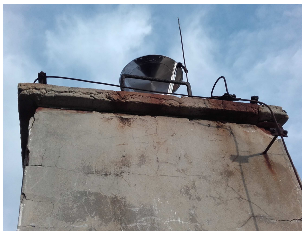
WYSADZINY OKŁADZINY TYNKOWEJ PRZEZ ZŁASOWANE CEGŁY NA KOMINIE
