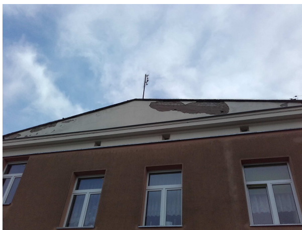
UBYTKI TYNKU NA ŚCIAN. SZCZYTOWYCH
