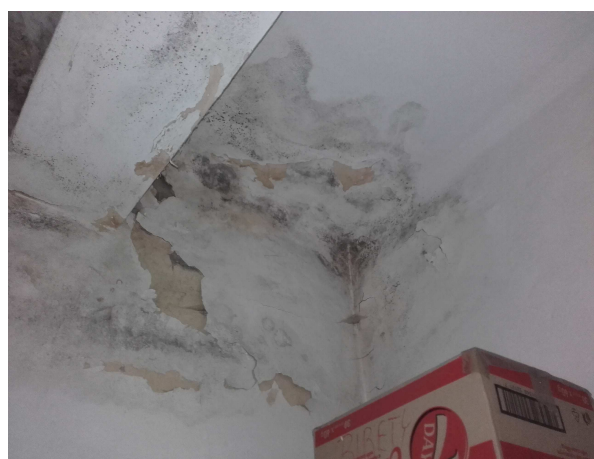
GRZYB I ODPADAJĄCY TYNK NA KL. SCH.
