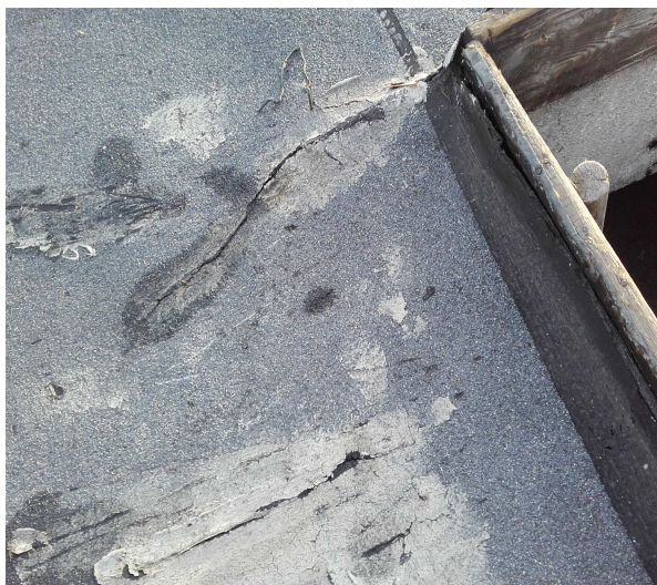
PĘKNIĘCIA W PORYCIU
